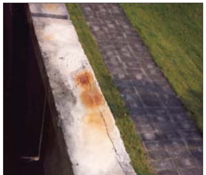
Armbrydning, hvor manglende dæklag har ført til armeringskorrosion med deraf følgende udfældninger og revner.
